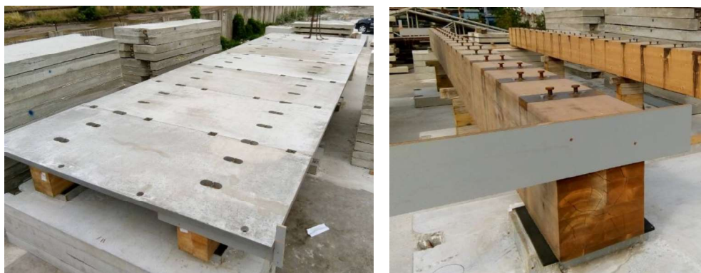
Obr. 5 Vlevo zkušební uložení panelů na trámy před instalací spřahovacích prvků, vpravo osazené spřahovací prvky do kapes na trámech v areálu firmy KŠ-Prefa s.r.o. ve Štětí
